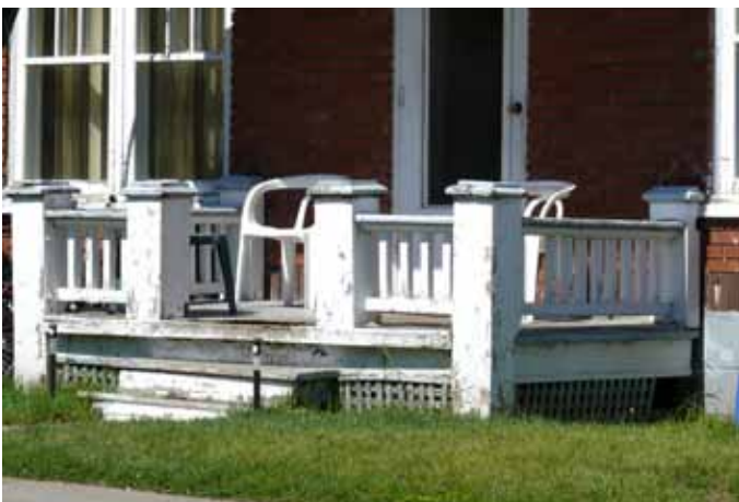
Garde-corps en bois délimitant la galerie de la maison sise au 9, rue des Érables.
