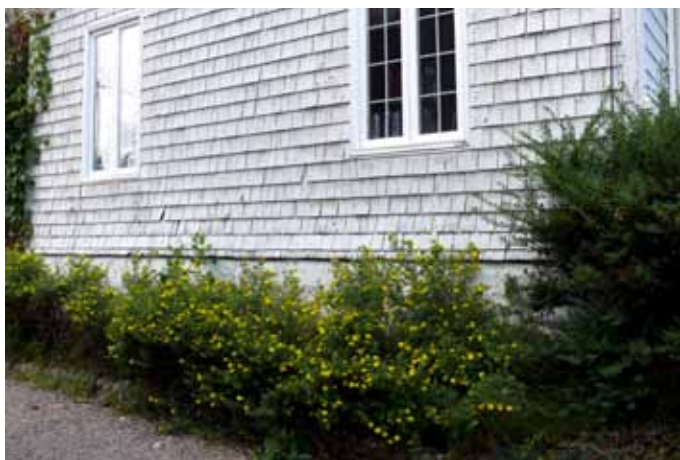
Revêtement de bardeaux de bois de la maison sise au 32, rue Maisonneuve.
