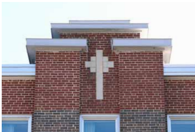
Parapet de brique de l'école Laure-Gaudreault sise au 19, rue Saint-Philippe.
