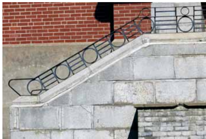
Garde-corps en fer de l'ancien escalier principal de l'école Laure-Gaudreault, sise au 19, rue Saint-Philippe.
