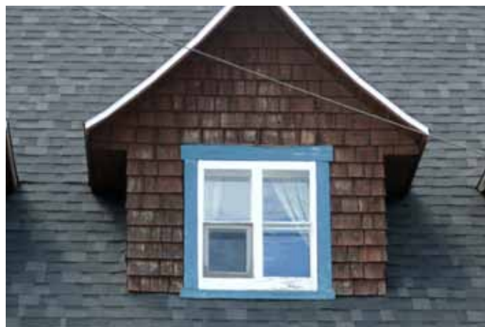
Lucarne recouverte de bardeaux de bois de la maison sise au 34, rue Maisonneuve.
